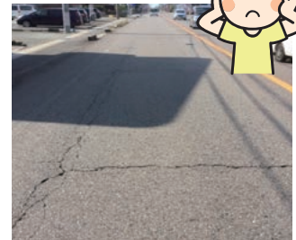
コンポジット舗装構造での 破損事例②
